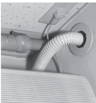
空調機まわりでの使用例
